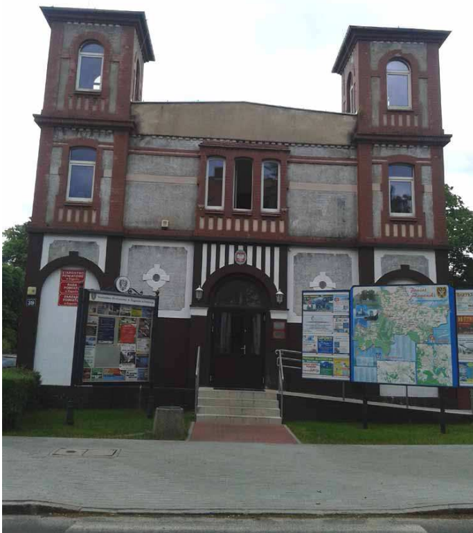
Elewacja frontowa - do renowacji i odnowy powłoki malarskiej.
