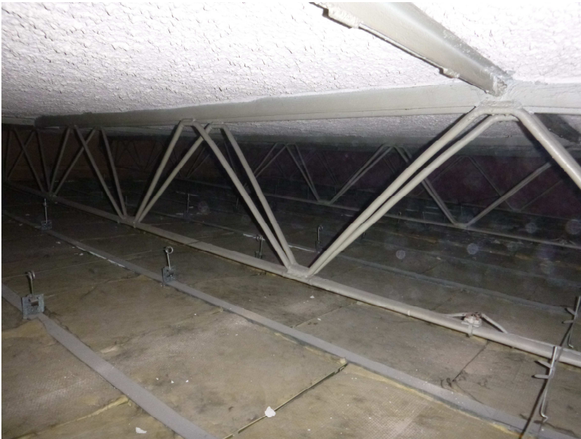
Strop podwieszany do stalowej konstrukcji nad salą narad.
