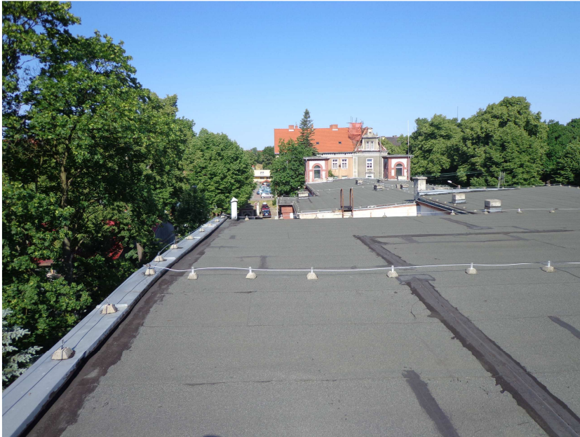
Opierzenia murków i instalacja odgromowa podlegająca wymianie.
