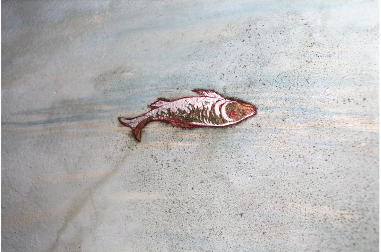
Ryc. 104. Polichromia w centralnej części sklepienia wnętrza loży. Widoczne brudne zacieki, a także czarne plamy, świadczące o zaawansowanym rozwoju mikroorganizmów.
