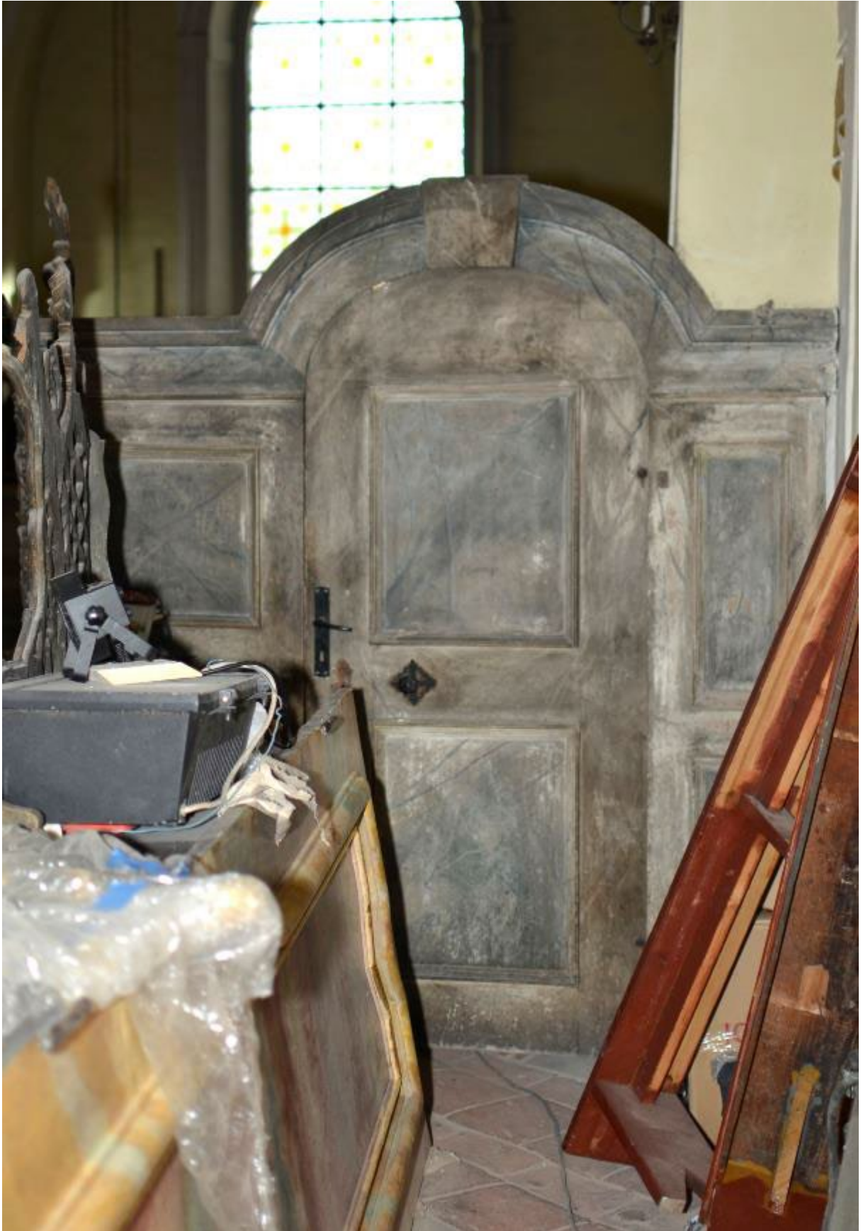
Ryc. 126. Przegroda empory – widok od strony wschodniej. Zachowana w pełni oryginalna XVIII-wieczna dekoracja malarska. Płyciny i część arkady z wyraźnym, błękitnym laserunkiem.
