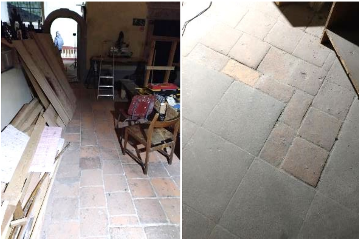
Ryc. 131. Posadzka w obrębie pomieszczenia 139 – stan zachowania. Widoczne lokalne zaburzenia wstępu i wtórne uzupełnienia wykonane przy użyciu płytek kamiennych.
