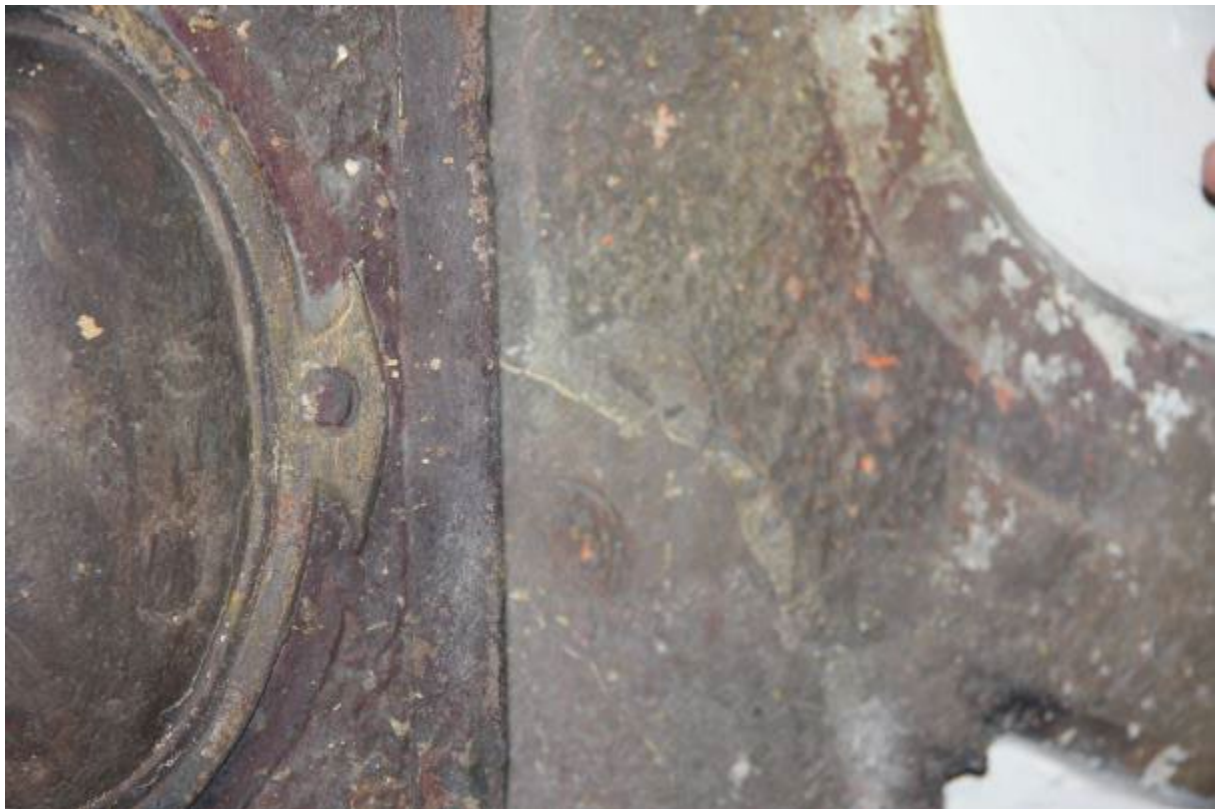
Ryc. 54. Fragment obramienia – widoczny stan zachowania warstwy marmoryzacji: obfite nawarstwienia i przetarcia powłoki.
