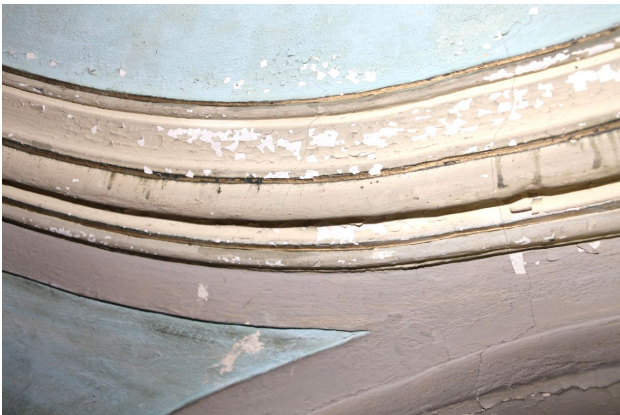
Ryc. 108. Wnętrze loży opackiej, sklepienie. Stan zachowania warstwy malarskiej sklepienia.
