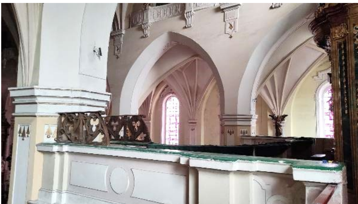
Ryc. 145. Widok z chóru muzycznego w kierunku południowo-wschodnim. Widoczna balustrada i filar wspierający chór organowy w jego północnym narożniku. W głębi arkady nawy głównej i południowa ściana kościoła. Zwraca uwagę neogotycka balustrada podwyższenia dla dyrygenta chóru pod filarem.
