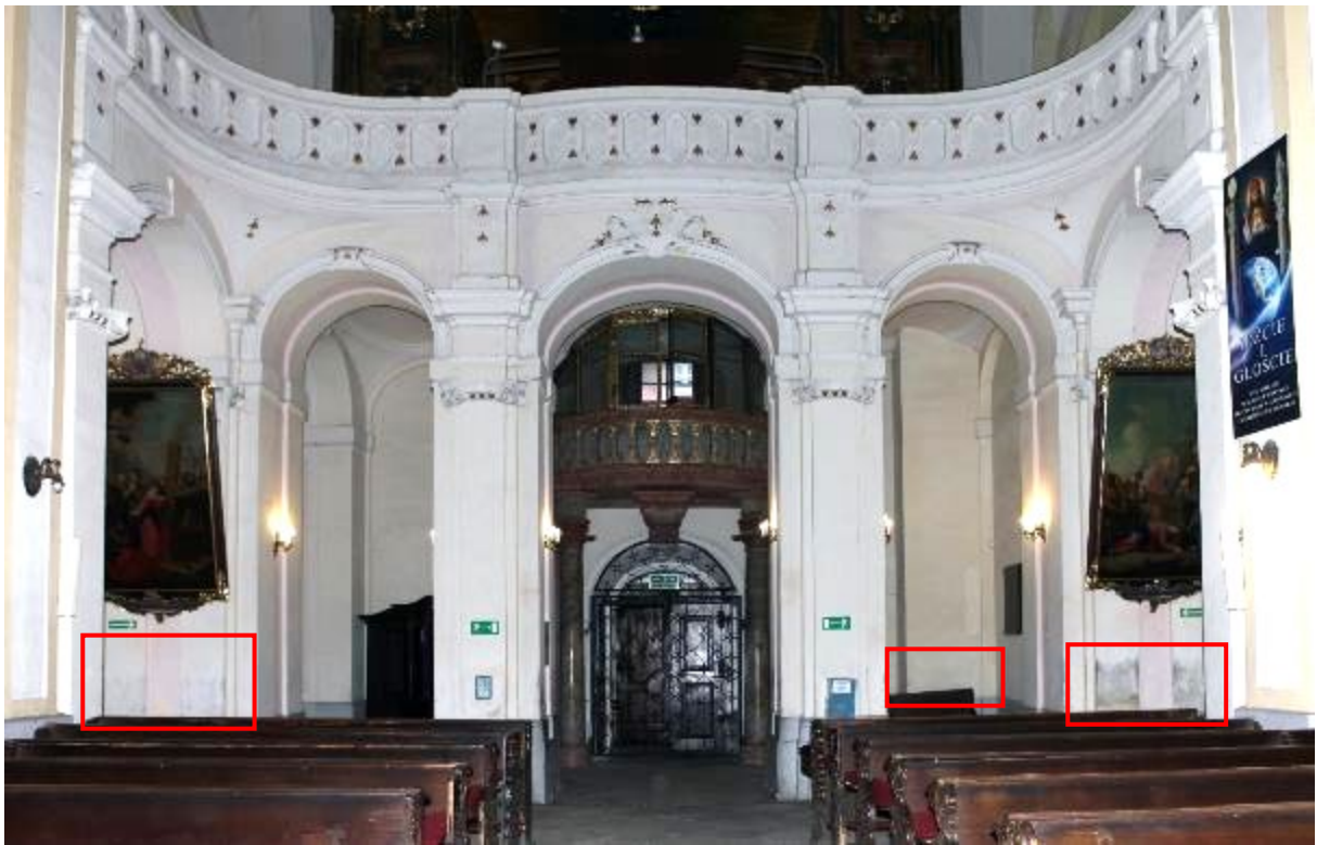
Ryc. 94. Widok ogólny na empore muzyczną od strony nawy głównej. Zaznaczono strefy przetarcia powłok malarskich.
