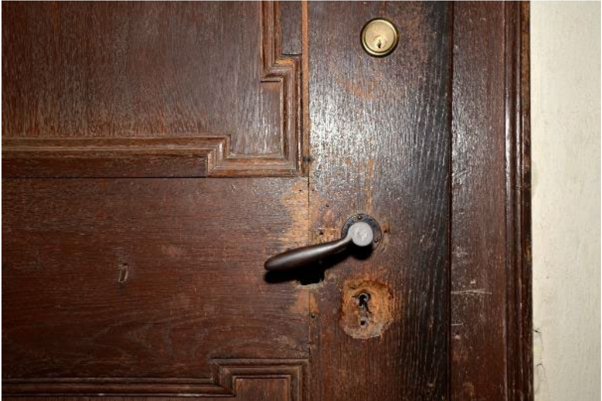
Ryc. 93. Detal drzwi wejściowych – widoczne uszkodzenia drewna w okolicach zamka, wtórny zamek i przetarta powłoka malarska.
