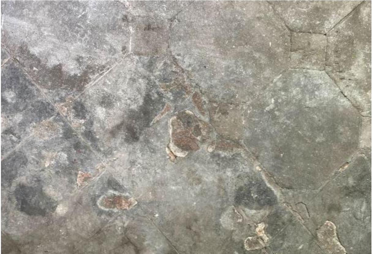
Ryc. 62. Fragment posadzki kaplicy. Płyty silnie wyeksploatowane, wtórnie pokryte warstwą wylewki cementowej. Po stronie prawej widoczny fragment pierwotnej posadzki.
