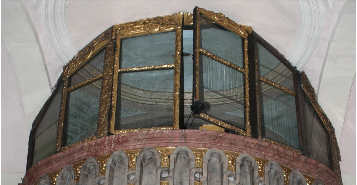
Ryc. 110. Loża opacka – okna. Widoczne sfazowanie górnej listwy krosna umożliwiające otwieranie okien pomimo krzywizny sklepienia.
