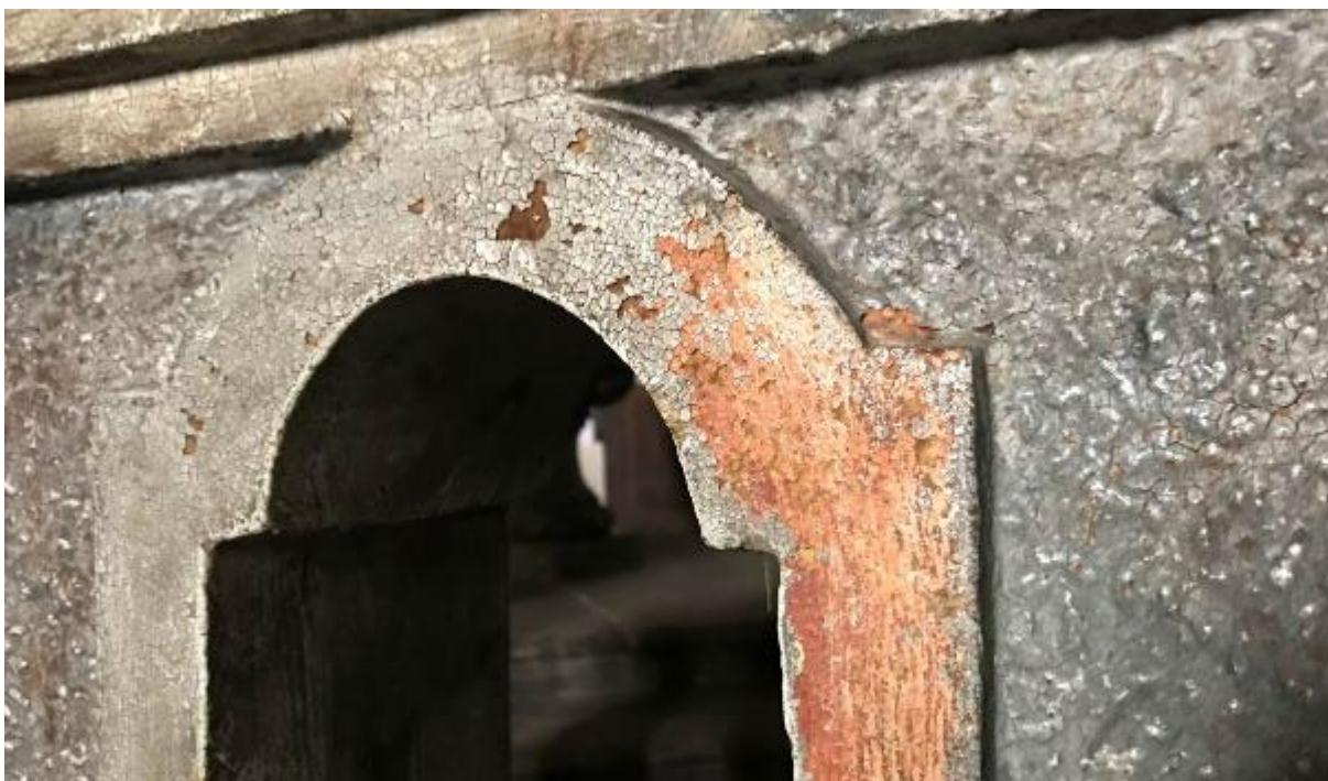
Ryc. 78. Balustrada, fragment ażurowego wypełnienia. Widoczny stan zachowania obecnej polichromii (ubytki, siatka spękań) oraz wcześniejsze warstwy malarskie (czerwona, pomarańczowa, brązowa).
