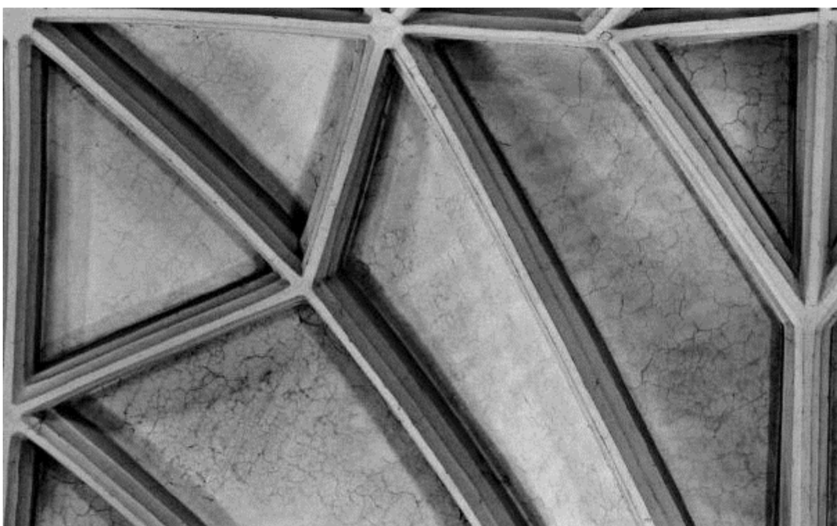
Ryc. 41. Przęsło 028.3 – spękania tynku pokrywającego wysklepki sklepienia. Zdjęcie po obróbce kontrastującej w skali szarości. Oprac. M. Kozarzewski.
