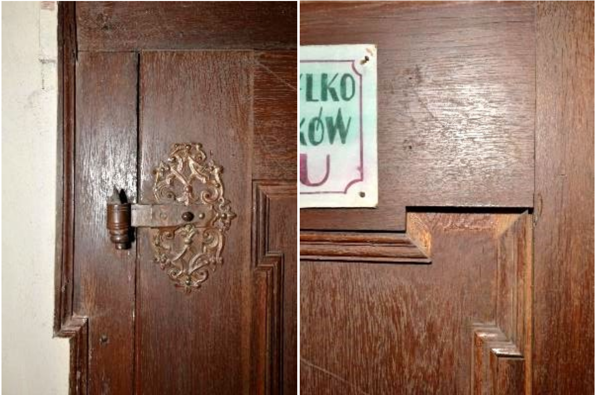
Ryc. 92. Detale drzwi zamykających wejście na chór – okucie zawiasów (po lewej), uszkodzenie profilowanej listwy ujmującej ptycine z uszakami.
