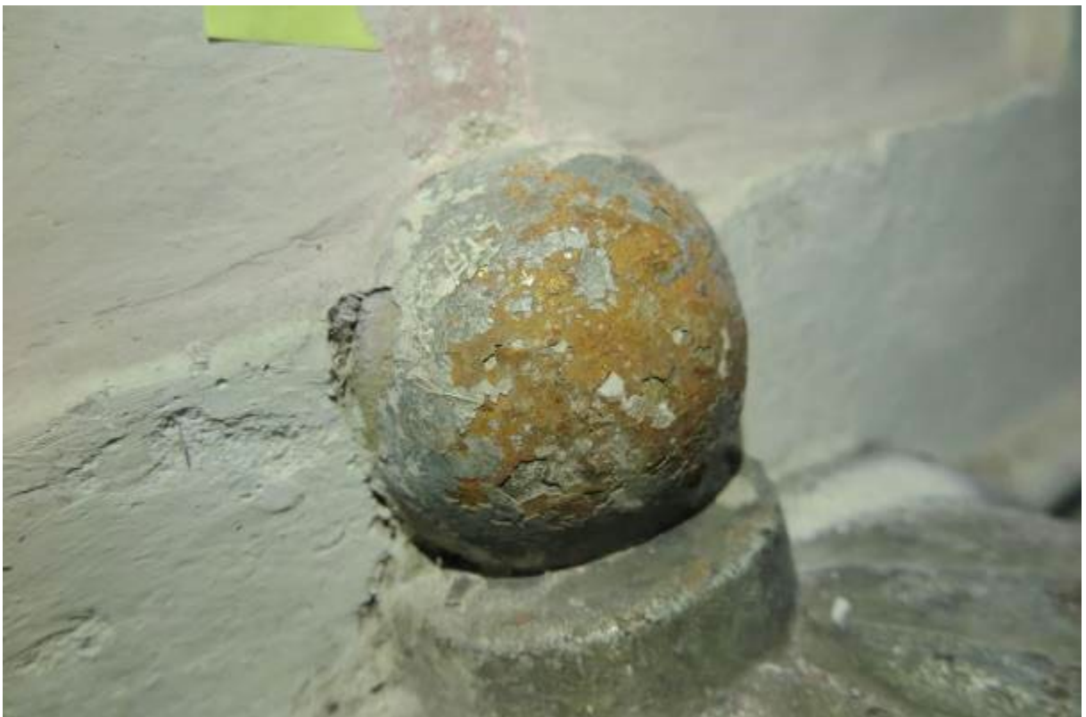
Ryc. 77. Balustrada, fragment zwieńczenia wazonu dostawionego do ściany bocznej. Widoczny stan zachowania obecnej polichromii - ubytki, siatka spękań oraz wcześniejsze warstwy malarskie (złocenie).
