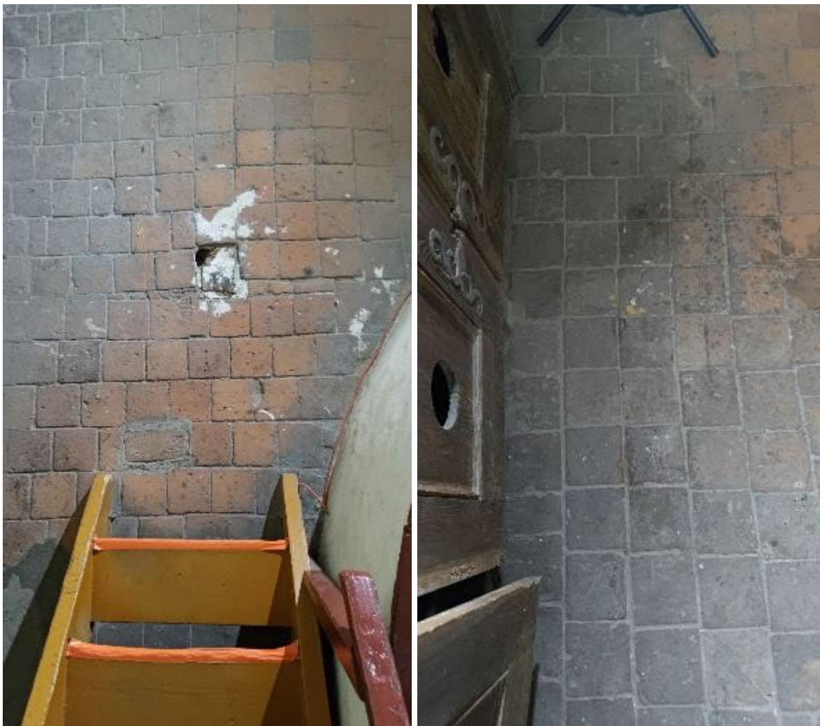
Ryc. 152. Fragmenty posadzek w obrębie empyry muzycznej – stan zachowania. Po lewej widoczne przetarcia i wtórne uzupełnienia związane z intensywnym użytkowaniem. Po prawej fragment posadzki wzdłuż szafy chórzystów.
