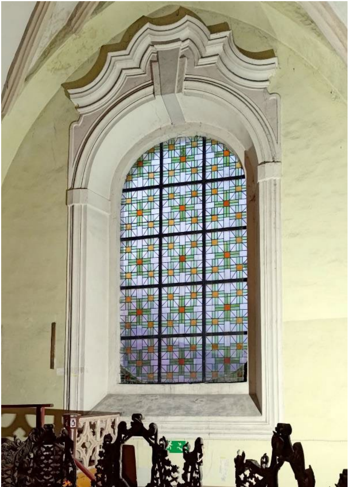
Ryc. 148. Okno w ścianie zachodniej kościoła, w obrębie empyry muzycznej – wtórne szklenie witrażowe i kolorystyka partii tynkarskich i sztukatorskich oraz obfite nawarstwienia i erozja tynków w rejonie sklepienia.
