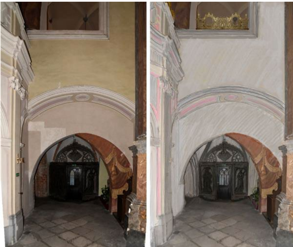
Ryc. 180. Zachodnia ściana nawy płn. i wnętrze O26 -zestawienie: stan obecny i próba odczytania historycznej kolorystyki. W przeswicie również była złocona kratownica (obecnie tylko ślad po niej na parapecie). Oprac. MK.
