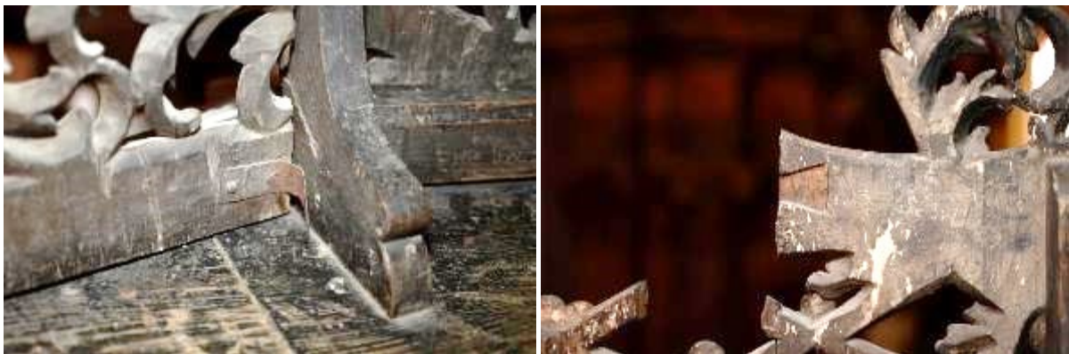
Ryc. 120. Detal. Po lewej: wtórne mocowanie paneli. Po prawej: ubytek elementu ramowego. Widoczne oryginalne gniazdo łączenia na jaskółczy ogon z oznaczeniem numeru połączenia (VII).
