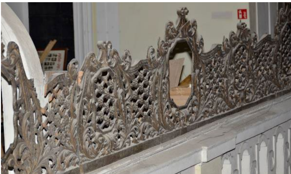
Ryc. 117. Fragment kraty w skrócie perspektywicznym. Widoczny zły stan zachowania.
