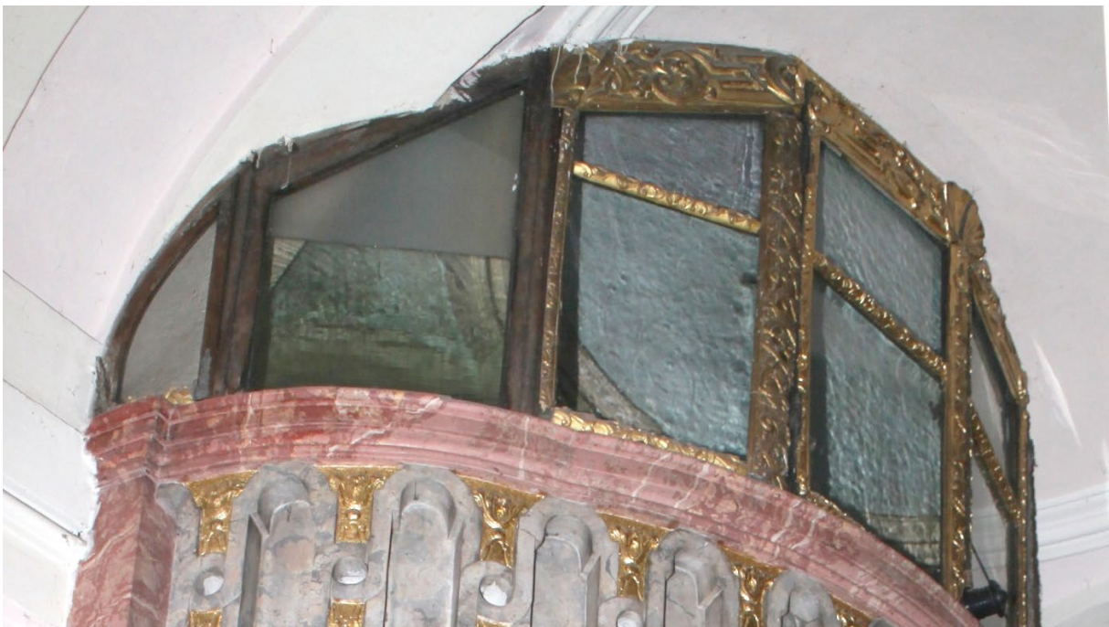
Ryc. 111. Loża opacka – przeszklenie. Widoczne ubytki dekoracyjnych nakładek oraz niehomogeniczne przeszklenie.
