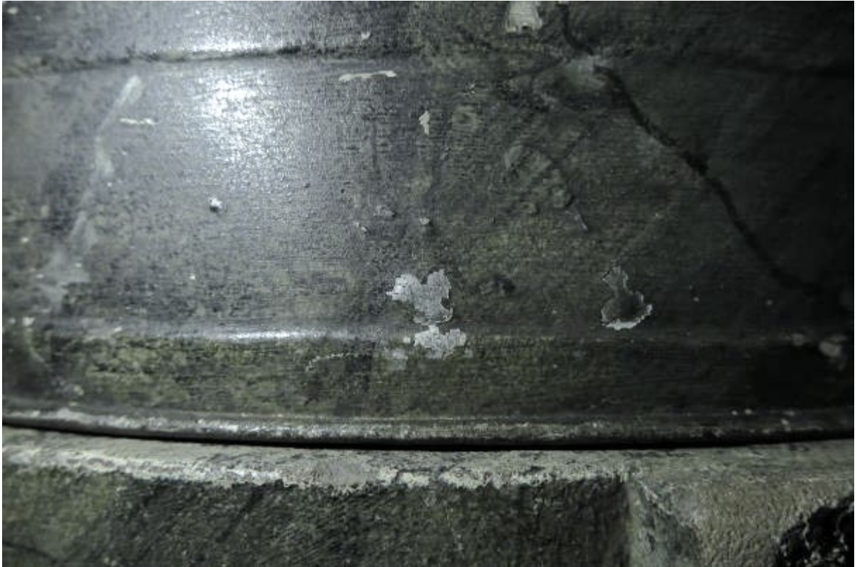
Ryc. 82. Chrzcielnica – miejsce styku kamiennego korpusu oraz blaszanej pokrywy.
