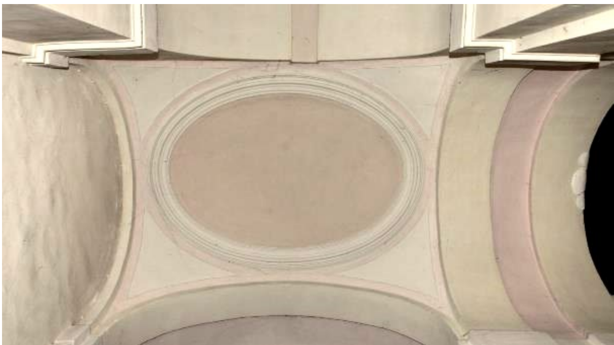
Ryc. 95. Przęsło w pom. 038 od strony południowej – sklepienie żaglaste z wpisany w nie owalem ujętym profilowanym obramieniem sztukatorskim. Widoczne nawarstwienia kurzu na ścianach.
