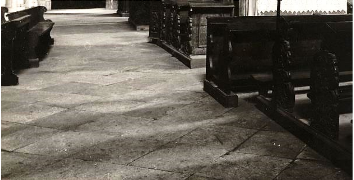
Ryc. 49. Posadzka nawy północnej – stan w latach 30. XX w. widoczne pęknięcia płyt i nieregularności powierzchni. Źródło: Herder-Institut fot. nr.126641 .
