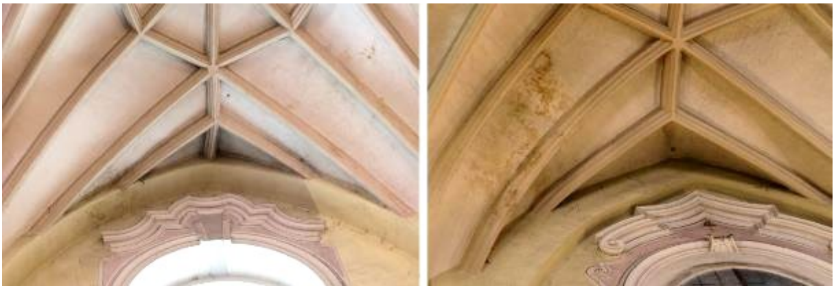
Ryc. 38. Przęśta 028.5 i 028.3 – stan zachowania w sąsiedztwie ścian zewnętrznych – występująca w różnym natężeniu erozja wypraw tynkarskich na wysklepkach i żebrach. Zwracają uwagę refleksy barwne od witraży.
