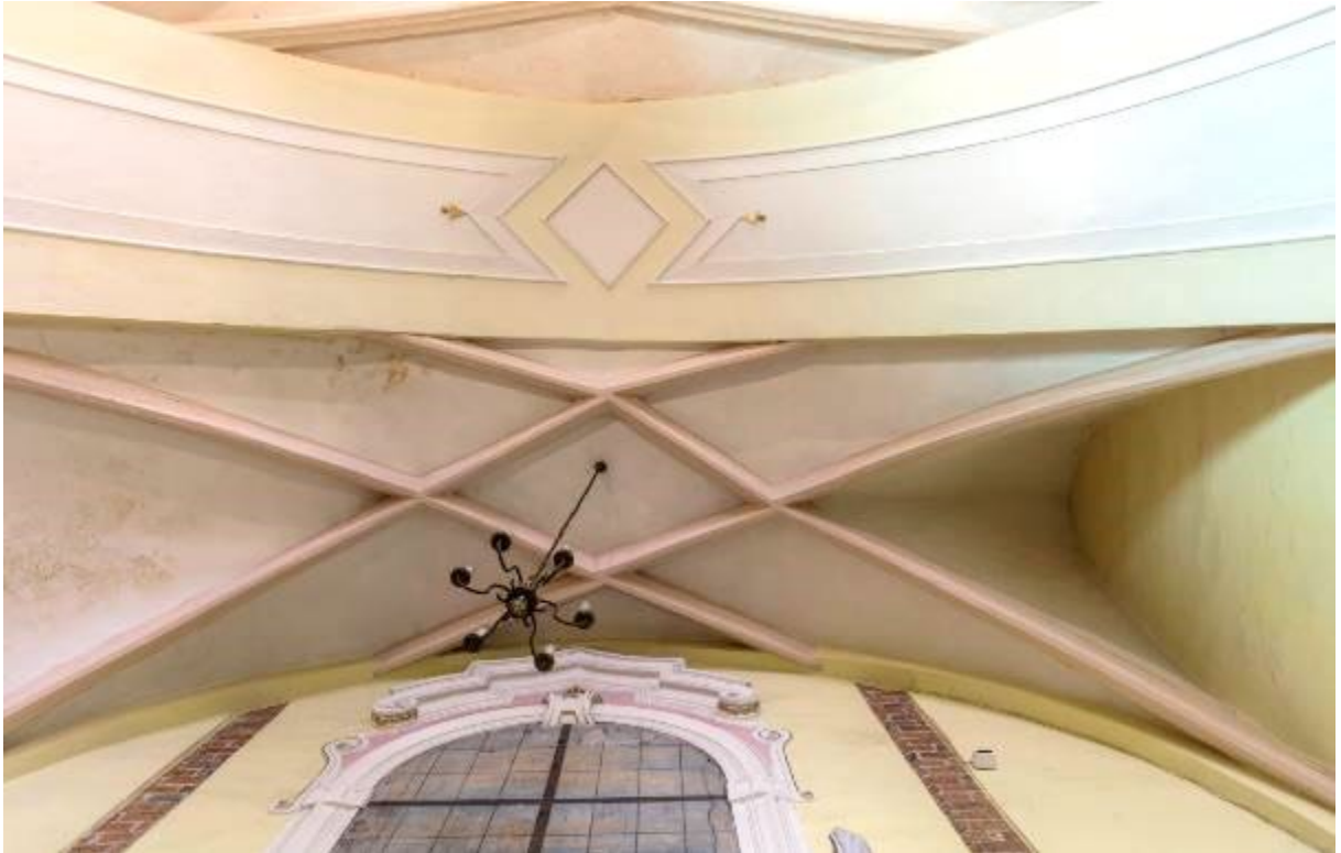
Ryc. 132. Sklepienie pomieszczenia 139. Widoczne są żółte przebarwienia oraz ubytki farby spowodowane zalaniem.
