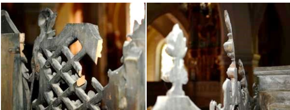
Ryc. 122. Detal. Po lewej: ubytek formy rzeźbiarskiej – przetłamani narożnik kratki regencyjnej. Po prawej: spaszony detal – fiala.
