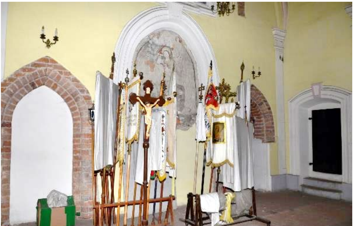
Ryc. 135. Wnętrze widziane w kierunku północno-wschodnim. Widoczne gotyckie łęki i relikty polichromii odsłonięte w latach 80. Po prawej stronie drzwi prowadzące do dawnego archiwum poprzedzone dwoma stopniami (pom. 140).
