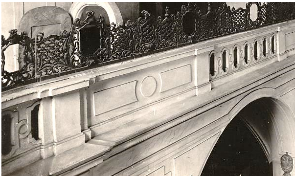
Ryc. 161. Empora nawy pñ., stan w latach 30. XX w. Charakterystyczne spękania wyprawy profili ciągnionych. Źródło: Herder-Institut, fot. nr 126640 (fragment).
