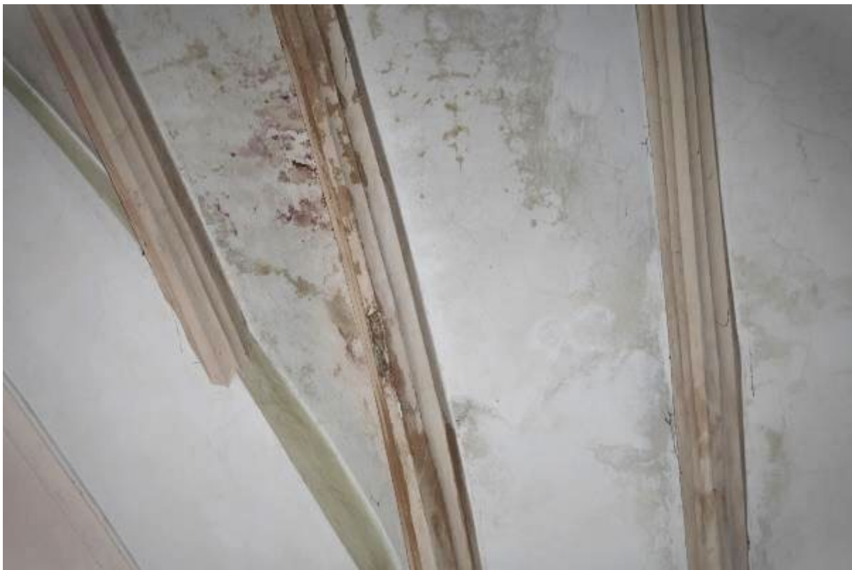
Ryc. 40. Przęsło 028.1 – uszkodzenia sklepienia spowodowane nieszczelnościami dachu. Stan obecny.
