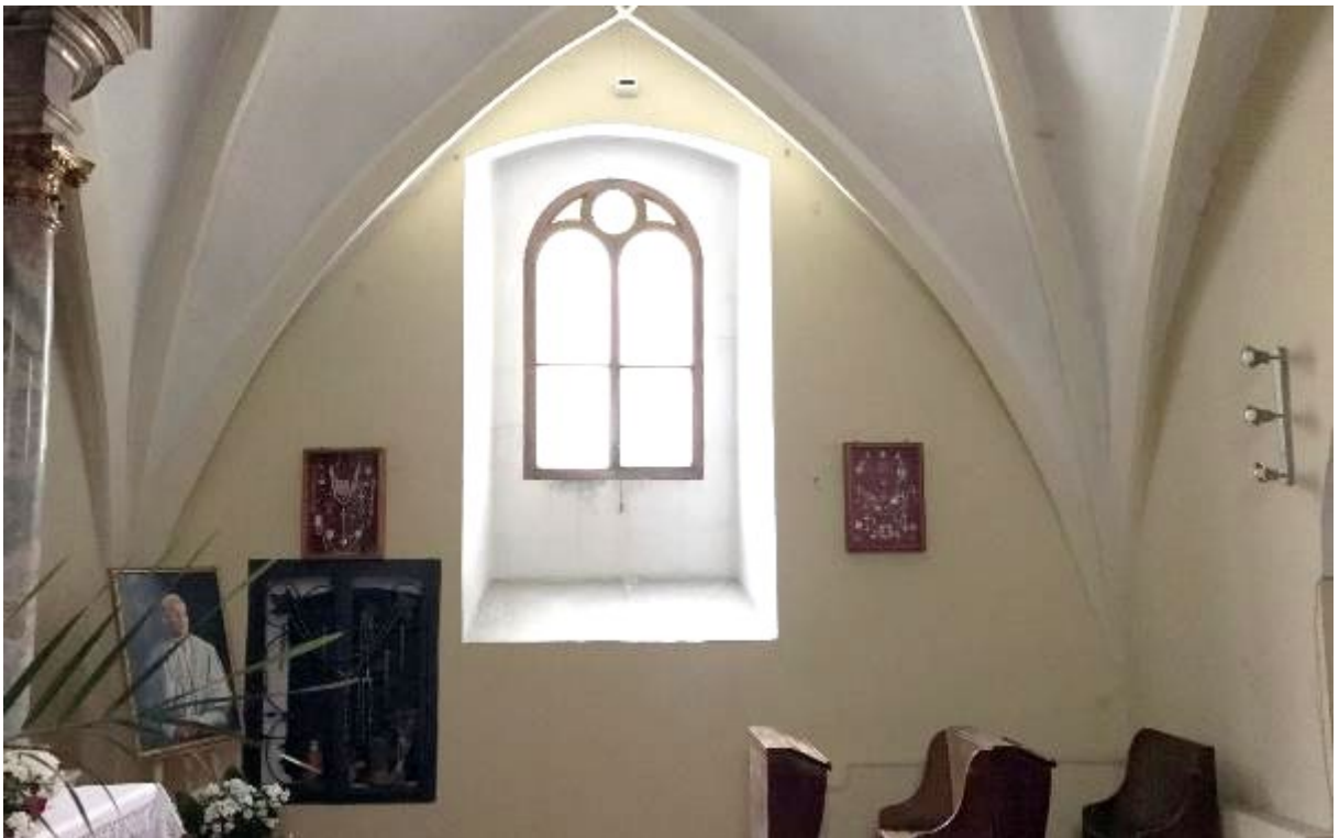
Ryc. 63. Okno we wschodniej ścianie kaplicy Najświętszego Sakramentu. Widoczne ciemne zacieki poniżej dolnej krawędzi okna.
