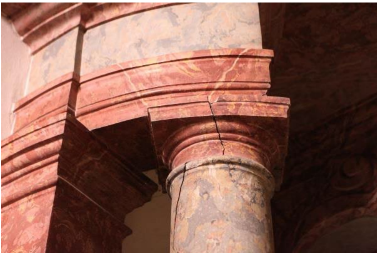
Ryc. 98. Łoża opacka, kolumna południowa. Widoczne spękania i ubytki formy obejmujące zarówno głowicę, jak i trzon kolumny.
