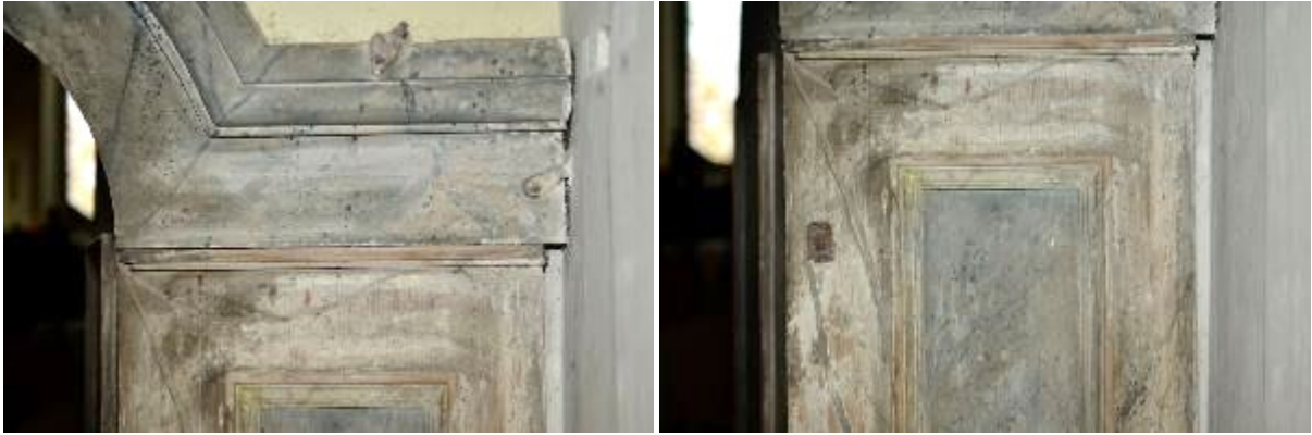
Ryc. 127. Detal. Po lewej: fragment belki wieńczącej z profilowaniem. Widoczne mocowania elementu do ściany. Po prawej fragment laserowanej błękitem płyciny. Liczne przemycia i przetarcia powłoki malarskiej.
