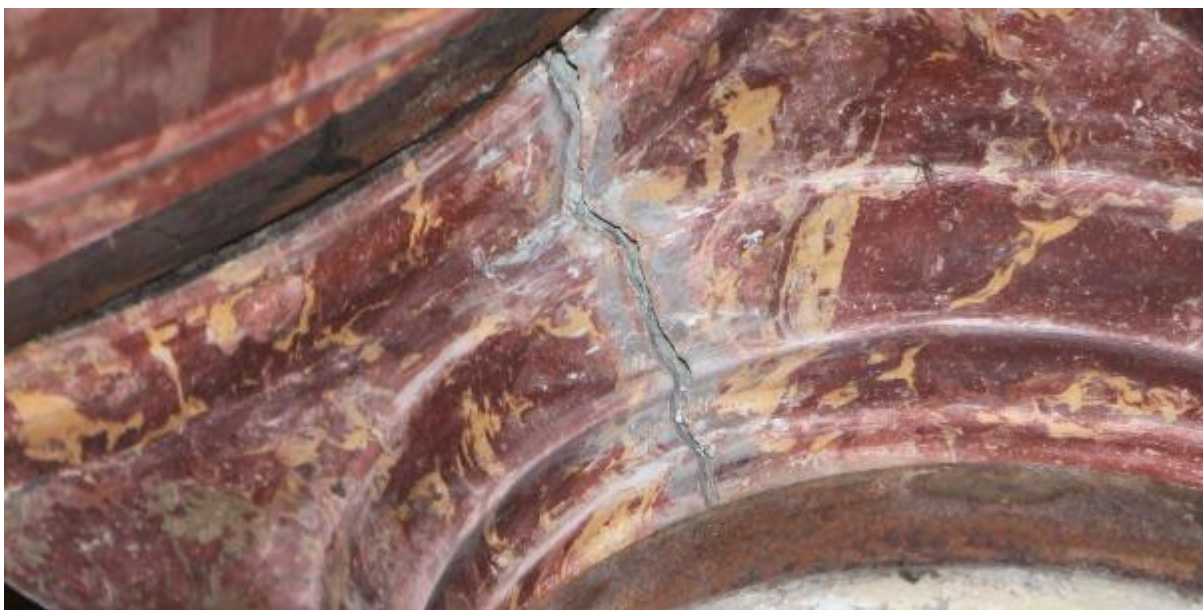
Ryc. 101. Łoża opacka, kolumna północna. Próba wypełnienia ubytku zaprawą cementową.
