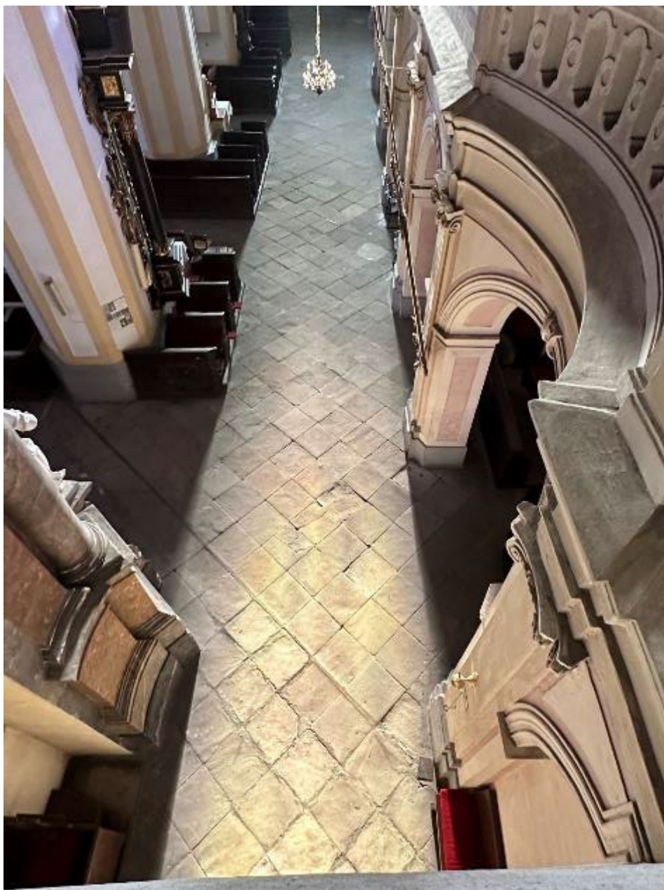
Ryc. 48. Widok na posadzkę z chóru zakonnego – bardzo dobrze widoczne uszkodzenia i nierówności.
