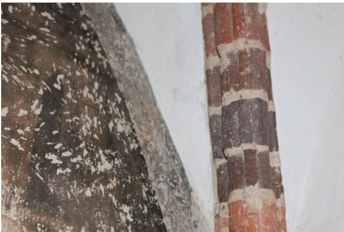
Ryc. 14. Malowidło ściennie na ścianie zachodniej – widoczne ceramiczne kształtki żeber sklepiennych i stopień zniszczenia warstwy malarskiej na ścianie zachodniej.
