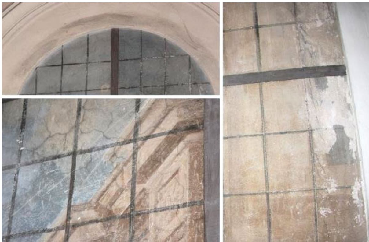
Ryc. 43. Stan zachowania iluzjonistycznego malowidła w górnej części ściany północnej przęsa 028.3 (poziom empory 138). Widoczne są zadrapania, przetarcia, lokalne odspojenia warstwy malarskiej oraz rozległe ubytki. Można również zauważyć ślad zamalowanego krosna okiennego.
