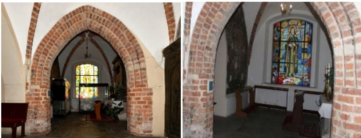
Ryc. 7. Wejście do gotyckiej kaplicy (pom. 025), obecnie Maksymiliana Kolbego. Odsonięty wątek ceglany łęku – w dolnych partiach widoczne nawarstwienia. Na wprost współczesny witraż przedstawiający św. Kingę.
