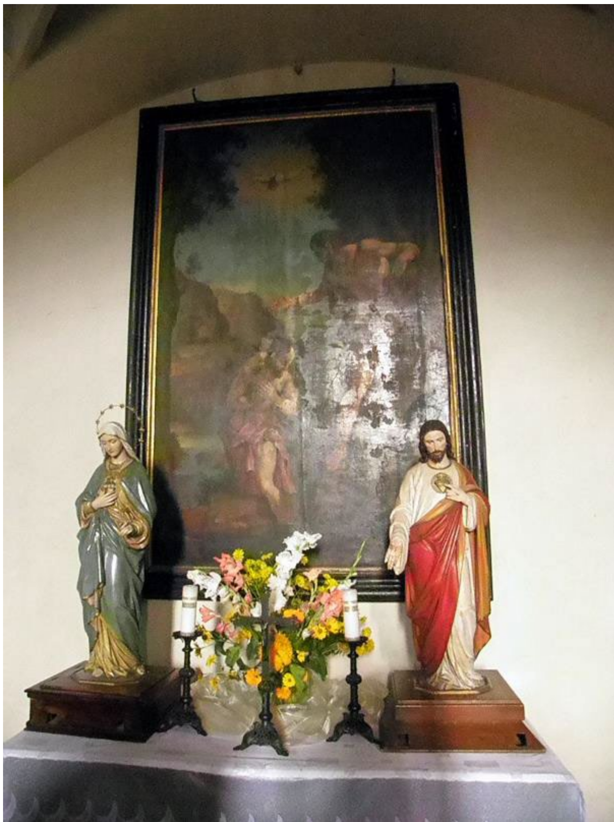
Ryc. 87. Obraz „Chrzest w Jordanie” na ścianie ptn. Widoczny zły stan malowidła.
