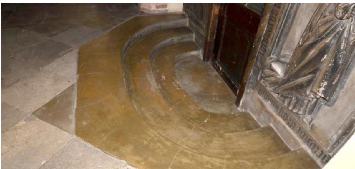
Ryc. 32. Schody pograżone ku części klasztornej. Widoczne spękania warstwy polerowanego betonu.
