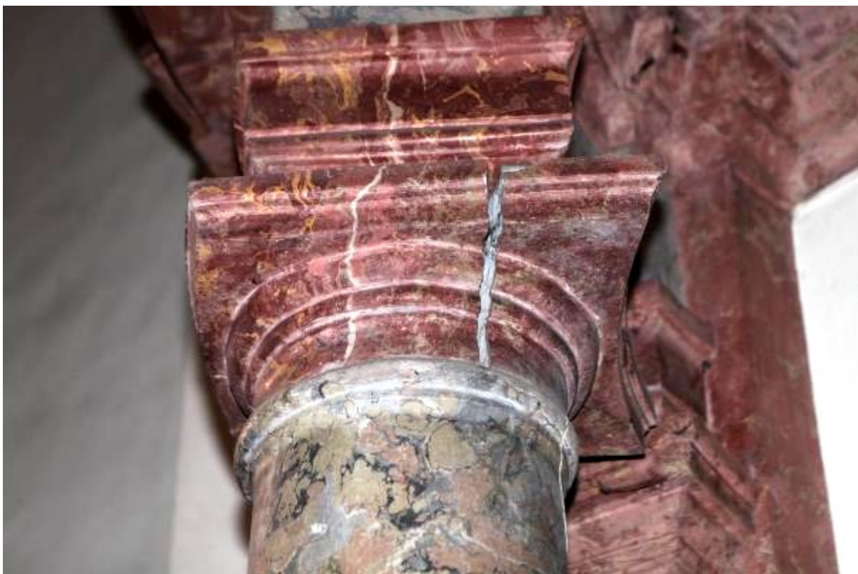
Ryc. 99. Łoża opacka, kolumna południowa. Widoczne głębokie pęknięcie głowicy.
