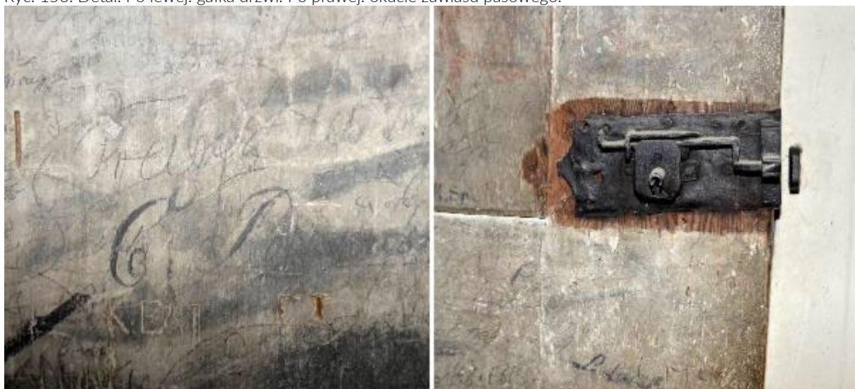
Ryc. 157. Detal: inskrypcje na drzwiach. Po prawej: uszkodzone zamknięcie – brak puszki ostaniającej mechanizm.
