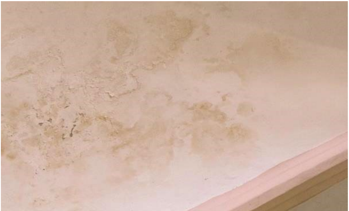
Ryc. 133. Sklepienie – stan zachowania. Warstwa malarska łuszczy się, a wokół ubytków widoczne są żółtobrunatne przebarwienia.
